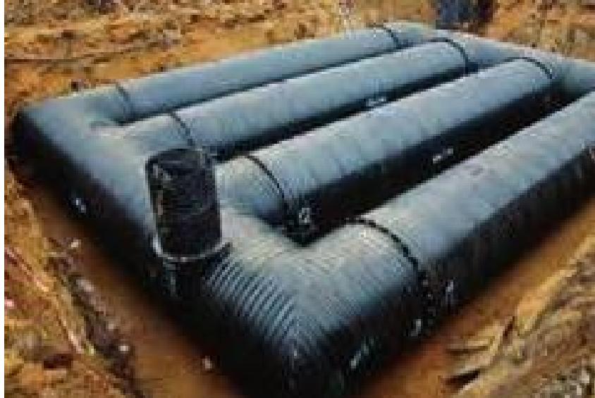
Kuva 3. Hulevesisäiliö. Lähde: ViaCon Oy.
